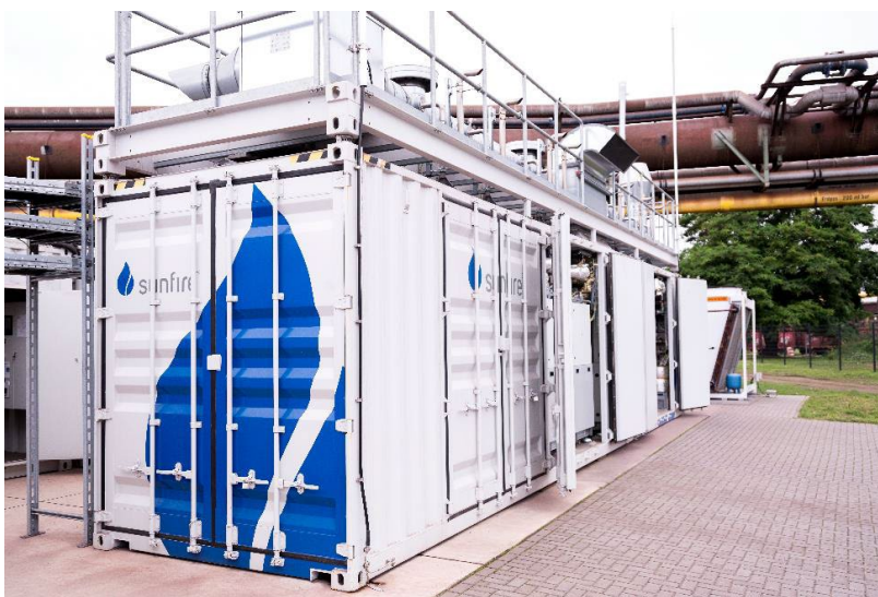
GrInHy2.0 Hochtemperatur-Elektrolyseur im Stahlwerk Salzgitter (© Salzgitter AG)
